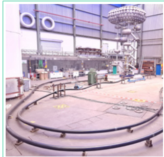
▲ 320kV HVDC PQ Test 선로
