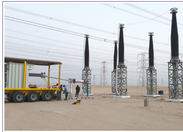
▲ 쿠웨이트 알 무틀라(Al-Mutlaa) 400kV 설치
