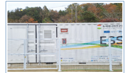
▲ 전라남도 나주 ESS 솔루션(1MWh)
