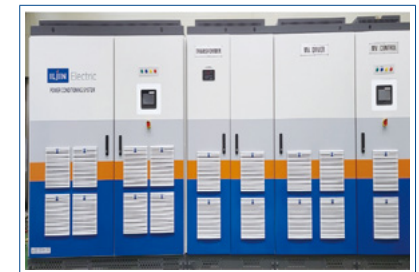
▲ 전라남도 나주 5kV DC컨버터(500KW)
