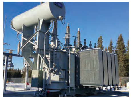
캐나다, 3상 138kV 42MVA
