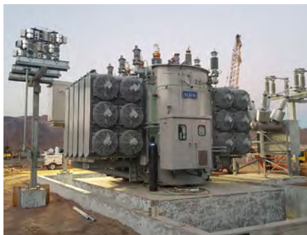
미국, 3상 69kV 150MVA
