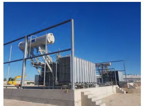
호주, 3상 132kV 45MVA
