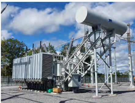
미국, 3상 500kV 350MVA
