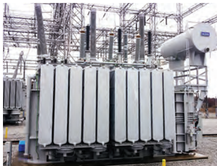
미국, 3상 345kV 448MVA
