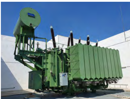
튀니지, 3상 225kV 200MVA
